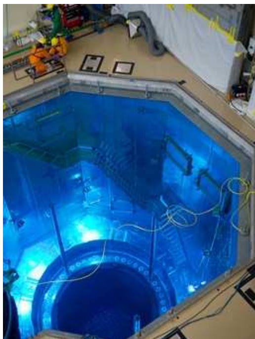
Reaktorbecken des KKW Grafenrheinfeld während einer Revision
