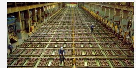
Abb. 5: Chlorelektrolyse mit Hg-Kontamination
