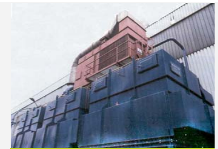
Abb. 3: Filteranlagen mit Aktivkohle-Festbettabsorbieren
